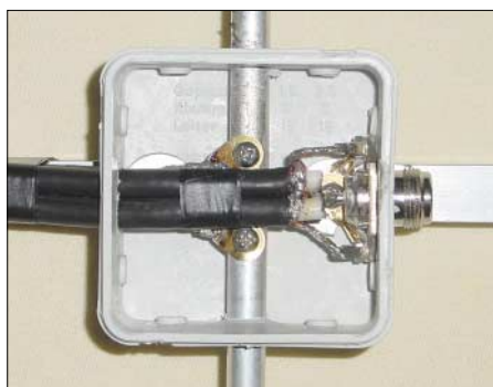
Bild 13: Blick in die Anschlussdose mit den Transformationskabeln aus H-155
